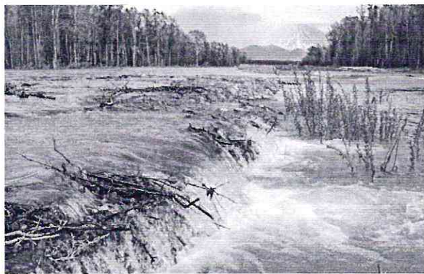
Рис. 23. Через год после реконструкции (фото 06.06.2013 г.). Даже после зимнего (декабрь 2012 г.) удаления части грунта из валиков обратной засыпки и углубления габионов в руслах ГТС в половодье продолжает функционировать как переливная дамба-перекат
