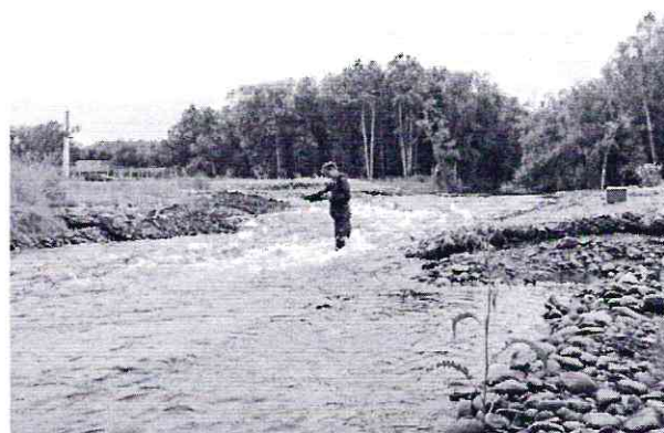
Рис. 20. Измерение скорости потока в русле одной из двух второстепенных пойменных проток р. Авачи через 4 мес. после завершения строительства ППМГ (реконструкции перехода МГ в траншею): в центре снимка – значительный искусственный перепад в створе габионов над валиками обратной засыпки, на заднем плане слева – блок-контейнер энергоснабжения кранового узла (фото 13.08.2012 г.)
