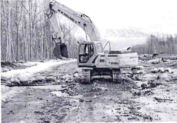
Рис. 15. Переезд вброд через русло второстепенной протоки в западной части долины р. Авачи с размещением в русле насыпей грунта и обрезков демонтированного трубопровода ВПМГ (фото 27.04.2012 г.)
