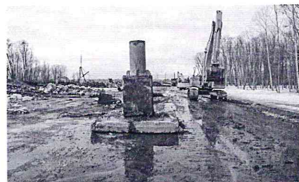
Рис. 14. Демонтированная эстакадная опора ВПМГ на столбчатом фундаменте, извлечённая из-под льда (наледи) в западной части долины р. Авачи (фото 27.04.2012 г.)
