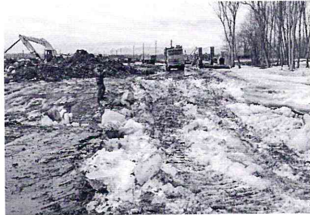
Рис. 16. Принудительно разрушенная экскаватором ледовая переправа через русло второстепенной пойменной протоки в западной части долины р. Авачи. Дальнейшие переезды техники через протоку осуществлялись вброд (фото 27.04.2012 г.)
