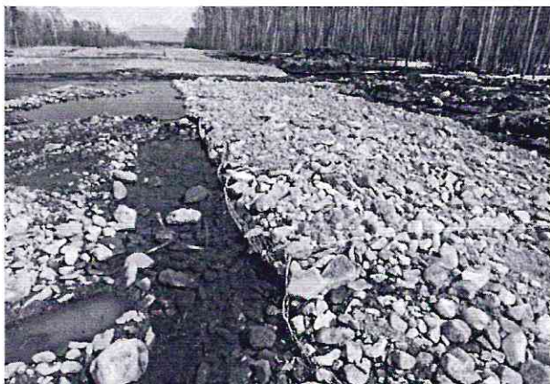
Рис. 19. Габионы в створе основной нитки. В результате нарушения естественного продольного профиля двух правобережных второстепенных проток и плано-высотных отметок прилежащих участков поймы после реконструкции перехода МГ образовались искусственные гидрологические ловушки для молоди лососей, в которых после снижения уровня воды в реке происходила их гибель (фото 16.05.2012 г., начало весенне-летнего половодья)
