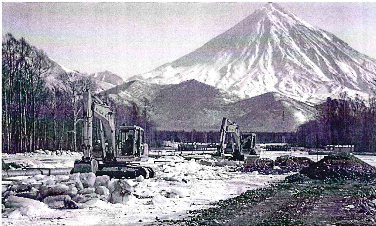
Рис. 2. Начало реконструкции воздушного (балочного) перехода МГ через р. Авачу по состоянию на 11.03.2012 г. В западной части долины с декабря 2011 по март 2012 г. шёл процесс интенсивного образования наледей, сопровождавшийся вмерзанием в лёд трубопровода
